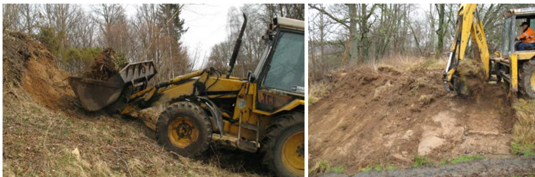
Figur 46 och 47. Johan Nilsson gräver bort en hassel med rötterna som beskuggar en befintlig sandblotta den 26 april 2010 (t.v.). Till höger grävs det översta lagret bort på en igenvuxen vägsränning i område 37 den 11 december 2009.
