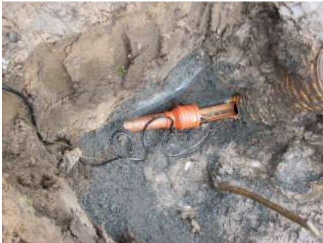
Figur 19. Flödesmätaren fästes i utloppsröret som byggdes på med en förminskning och en muff. Efter flödesmätaren leds vattnet till provbrunnen (Fotograf: Mika Thomasdotter).
